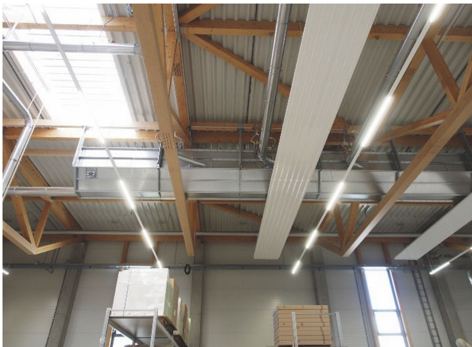
/ Der VacoFlow wird anstelle der üblichen Hauptrohrleitung installiert. Das gewonnene Material der Maschinen wird zunächst pneumatisch in den VacoFlow gefördert, anstatt den langen Leitungswegen bis zum Filter zu folgen.
